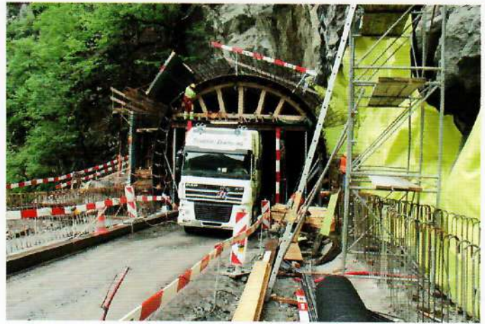
Abb. 7: Das Gewährleisten der Arbeitssicherheit während des Baus unter Verkehr war sehr anspruchsvoll
