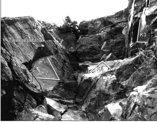
Fig. 17: Fels sackungsmasse mit Ausbruchnische von 1998 (Kreis), wo ein Felssturz von 20 m³ aus 30 m Höhe die Ponte Scalascia VI beschädigte. Die Ausbruchnische zeigt eine hohe Felszerlegung (unten).
