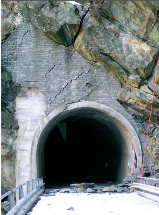
Fig. 8: Das Portal wird zerschert und verdrückt; wo das rechte Parament aufreisst, führt das Sammelkabel der Messgeber zum Datenlogger durch; trotzdem konnte bis 30 Minuten vor dem Absturz noch gemessen werden.
